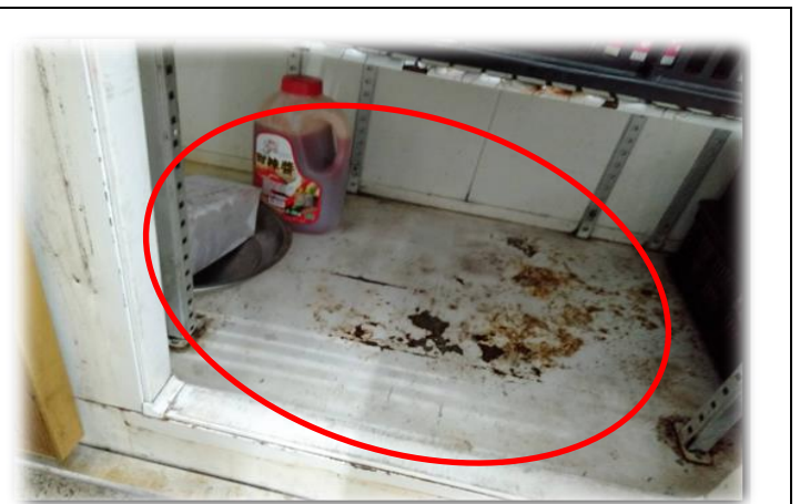
冰箱底部老舊剝落
