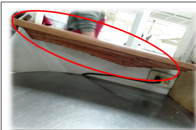
櫃子內面上緣老舊剝落
