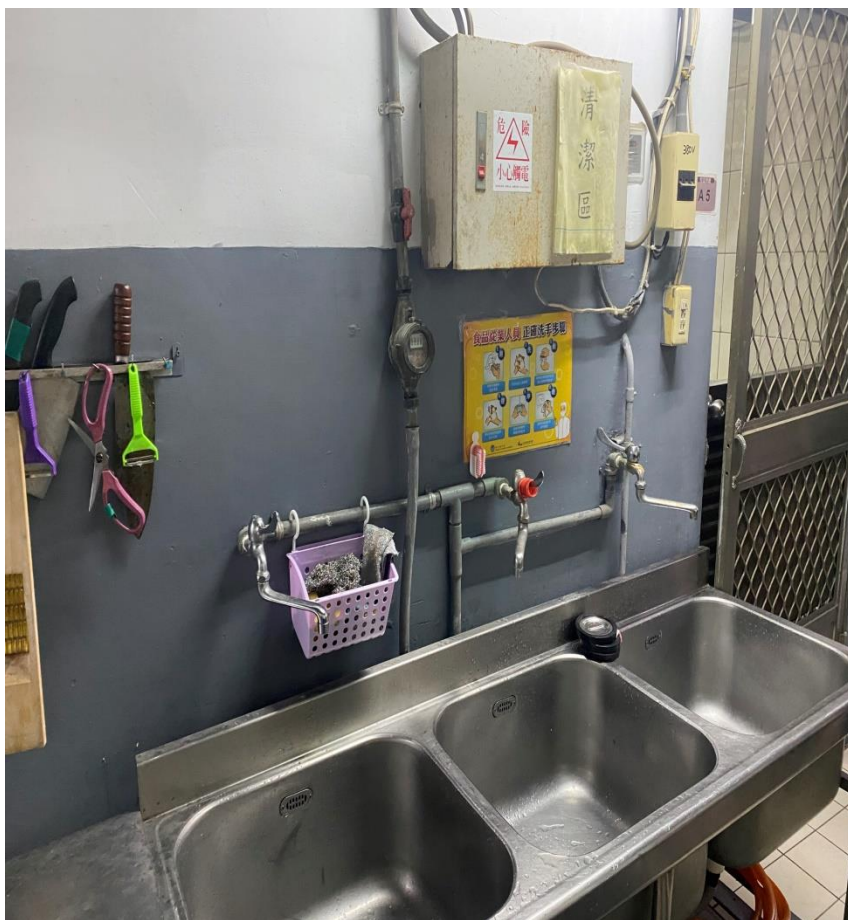
牆面與電箱管線表面不潔
