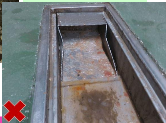
排水設施未清潔
