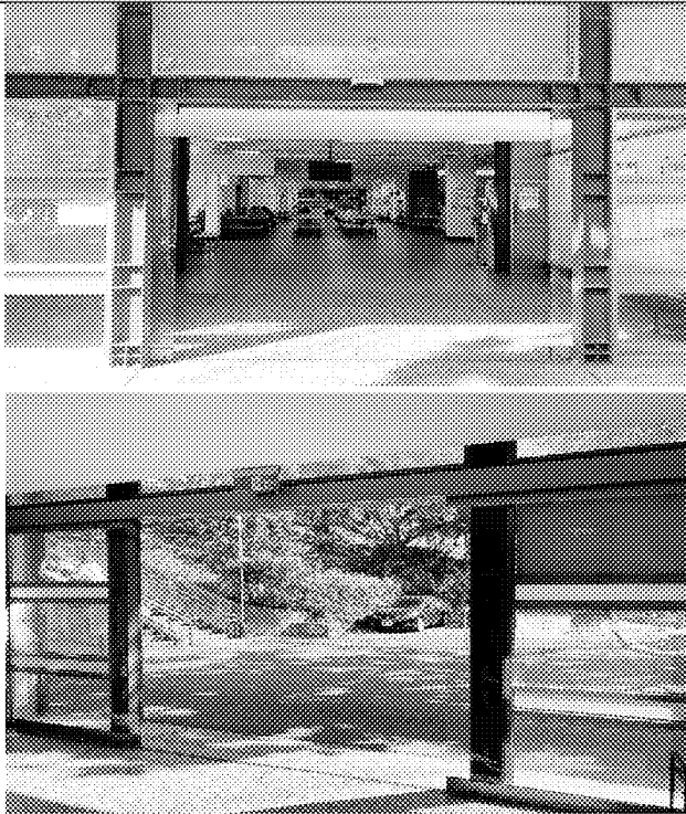
【圖一】大門電動門敞開，無法有效阻擋病媒。
